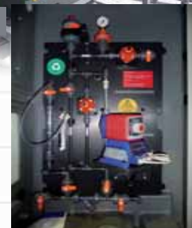
Dosage acide chlorhydrique 500 L/h
